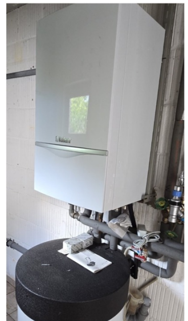
Gas-Brennwertheizung (2015) mit 120-l-Speicher
